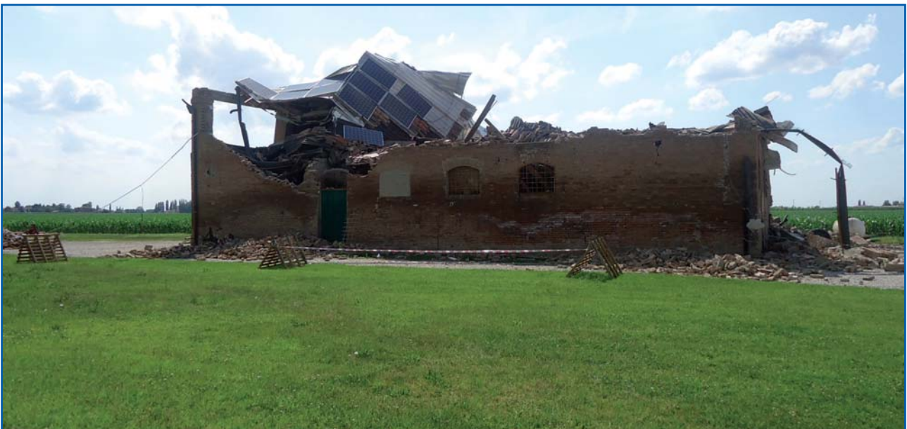
Crollo completo di edificio rurale di rilievo con impianto fotovoltaico integrato
