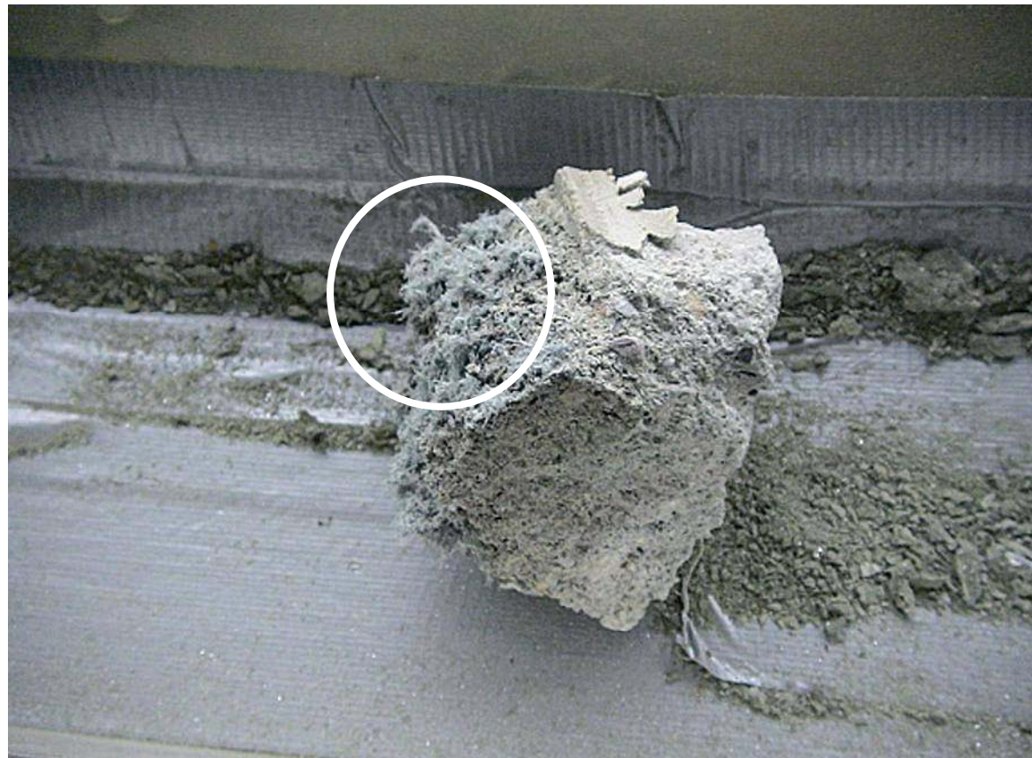
Massetto contenente amianto
