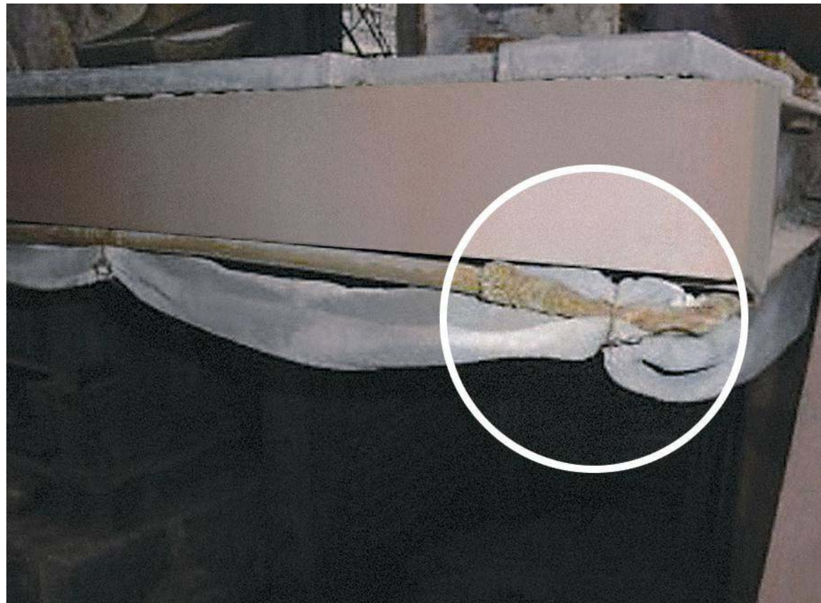
Tessuti ignifughi di amianto
