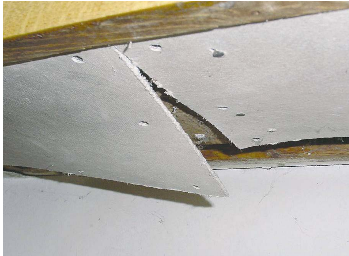
Pannello leggero contenente amianto (rivestimento antincendio)
