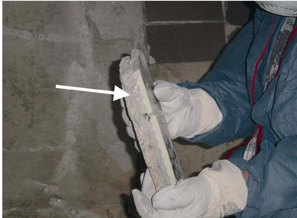
Supporti per piastrelle contenenti amianto
