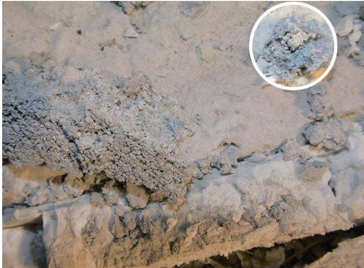
Parapetto contenente amianto (piscina)
