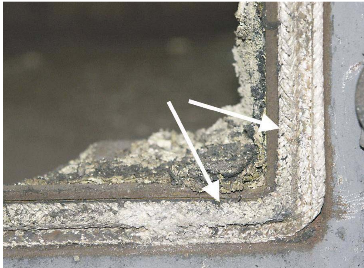
Stuoia isolante contenente amianto (caldaia)
