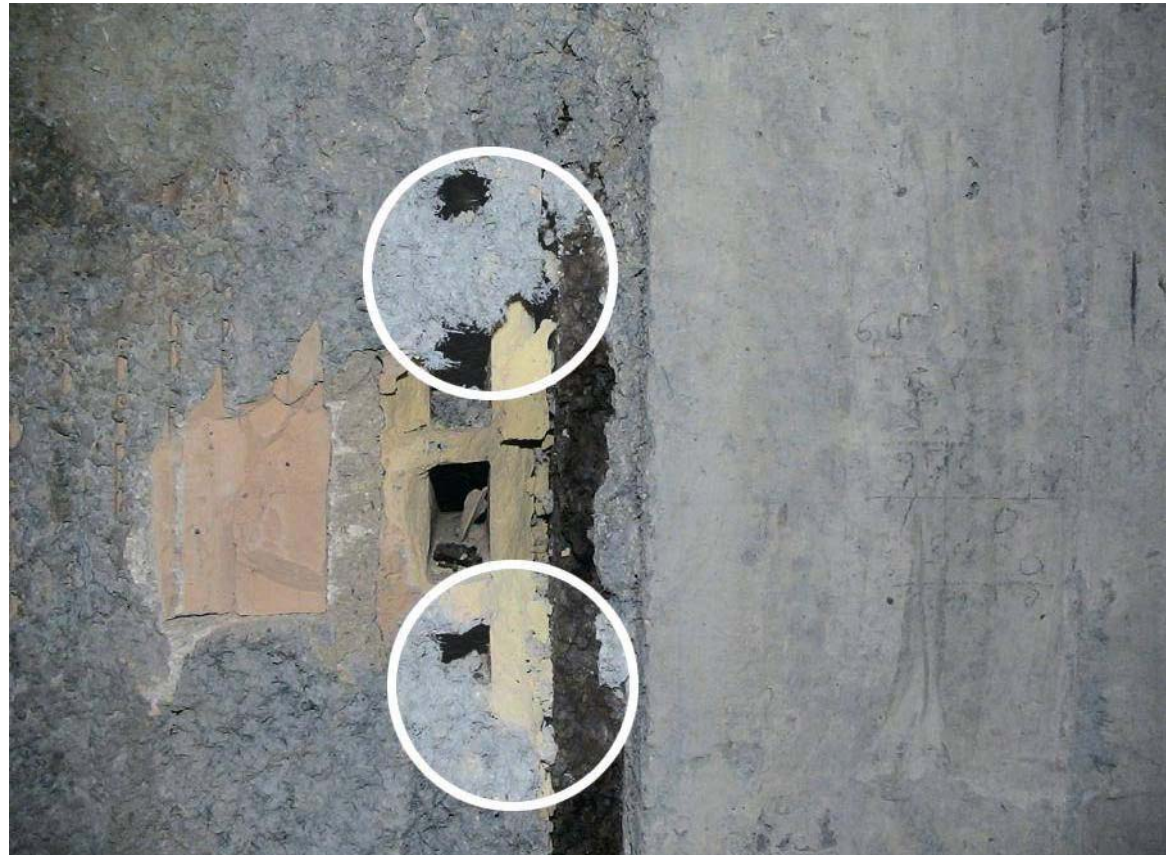
Amianto sui pilastri di murature
