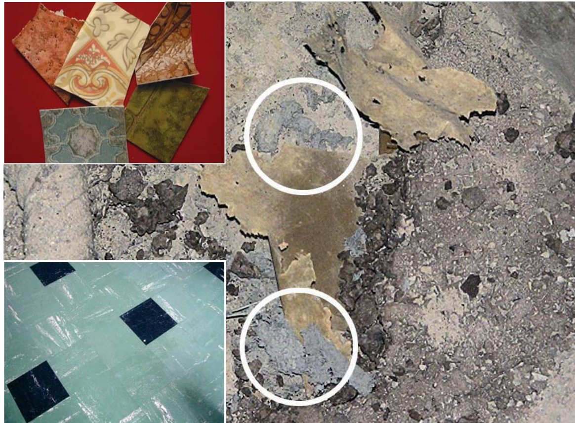
Massetto contenente amianto
