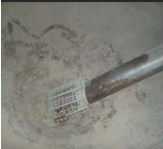
Protezione trasportatore a coclea, all'interno del silos
